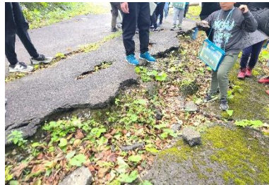
冷沢崩落地の崩壊した舗装道路
